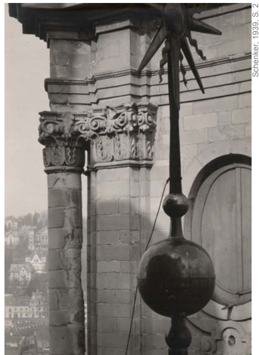
Abbildung 9: Die besonders stark verwitterten Sandsteine an den korinthischen Säulen vor 1928
